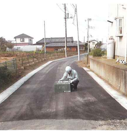
▲【施工手順⑤】アスファルトを敷いて完成。液状化対策に加え、道路の長命化、軟弱地盤対策、道路の凍結による凍上炎にも有効
